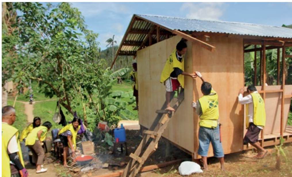
Frivillige fastgør krydsfiner til skelettet af et nyt hus i Tacloban på Filippinerne.
